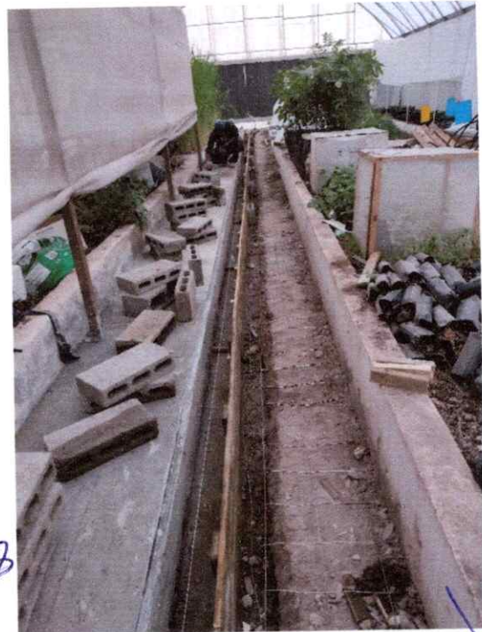
TENIENDO LISTO LOS MATERIALES SE PROCEDE AL ENCOFRADO CON MADERA, DEJANDO UN DESAGUE DE 0.23 MTS A LO LARGO DEL TUNEL
