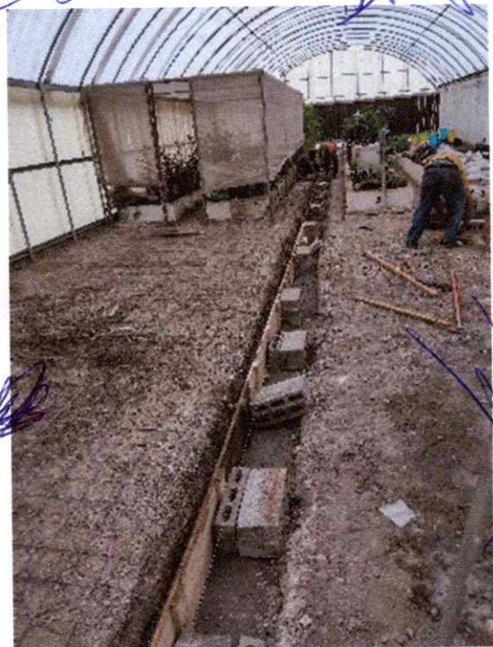
ENCOFRADO CON MADERA DE UN AREA PARA INICIAR LA COLOCACION DE PISO
