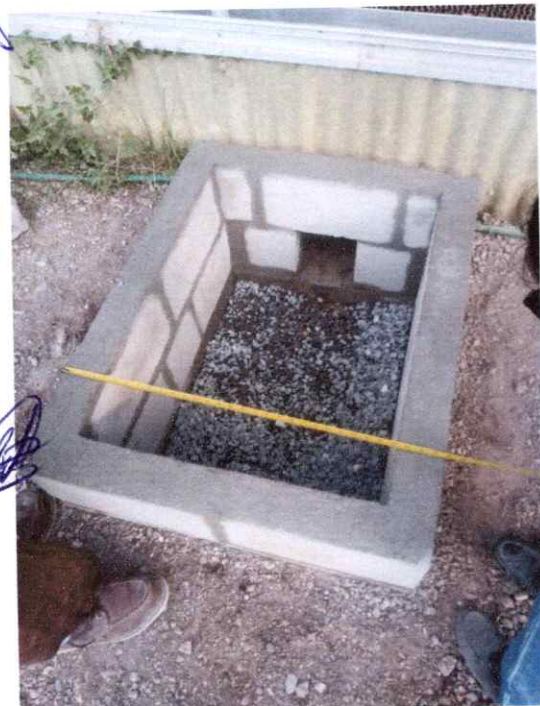
REGISTRO DE CAPTACION DE ESCURRIMIENTO Y FILTRACION
