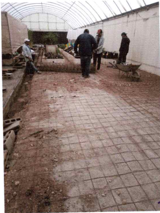
POSTERIOR AL TERMINO DE LA PRIMER ETAPA, SE REALIZA LOS PREPARATIVOS DE LA SEGUNDA ETAPA DEL PRIMER TUNEL
